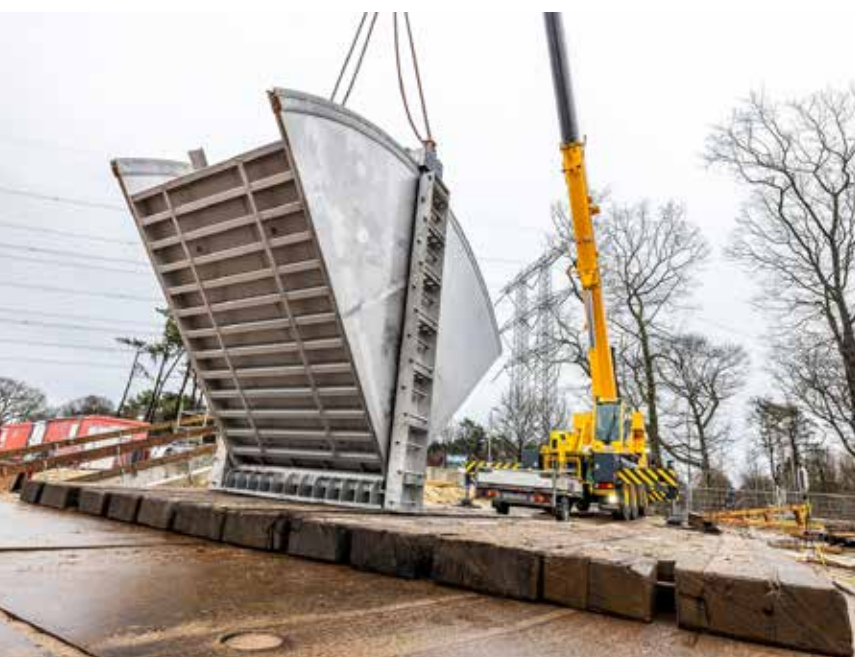
In het project worden drie nieuwe kantelstuwen aangelegd om de waterstand in de berging te kunnen beïnvloeden. (Beeld: Paul Poels)
